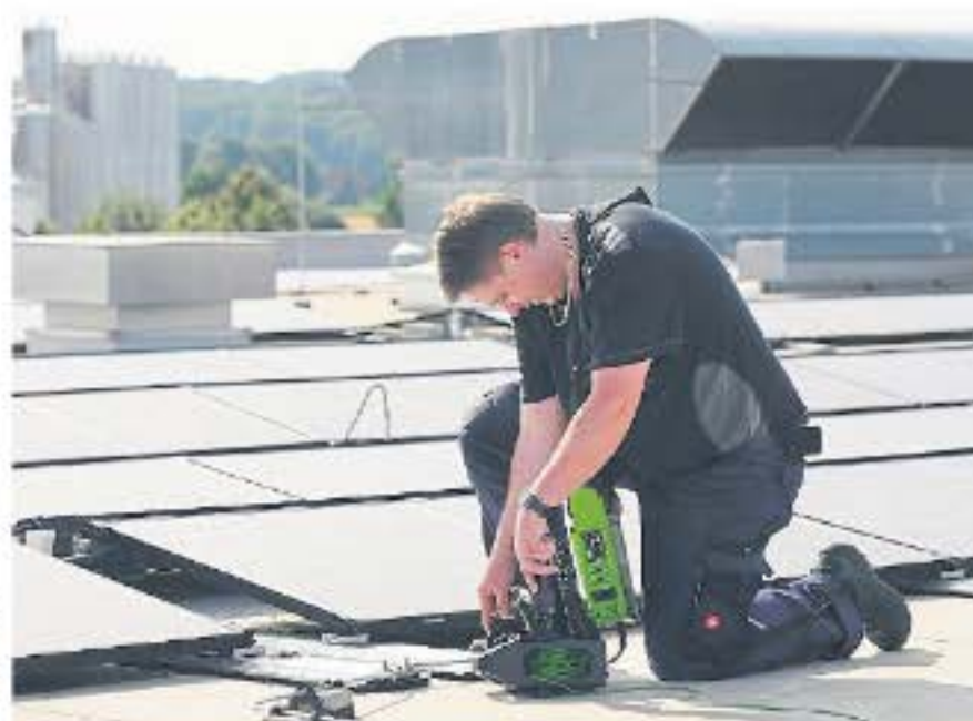
In Zeiten der Energiewende gehört auch die Überprüfung von PV-Anlagen zunehmend zu den Aufgaben. Fotos: Prüfhelden
